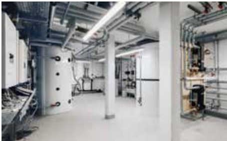
Technikzentrale mit Wärmespeicher (im Untergeschoss)
