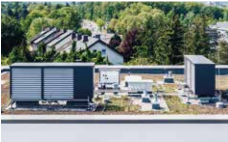
Schallentkoppelte Wärmepumpen (auf dem begrünten Flachdach)
